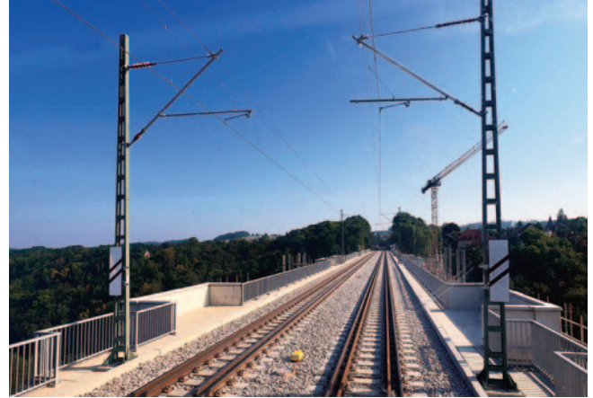
Zustand Fahrbahnwanne vor Instandsetzung Sommer 2021
